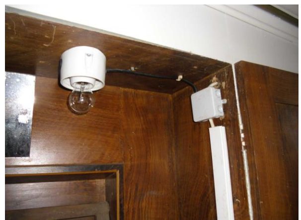
unschöne und blendende Installation
